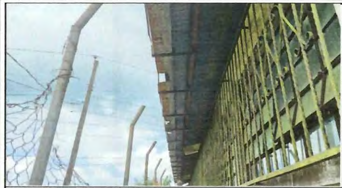
Foto 7: CANALES EN DETERIORO
