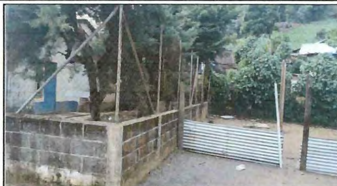
Foto 2: MURO PERIMETRAL A REPARAR AREA RECREATIVA DE LOS NIÑOS
